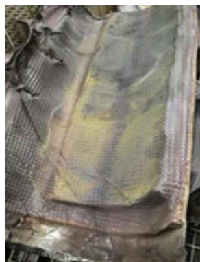
Gelber Staub unter einer Isolierung
