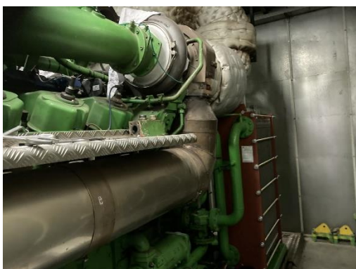
Pièce d'une centrale de cogénération
